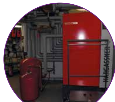
La nouvelle chaudière de L'heure bleue a été installée en 2018.
