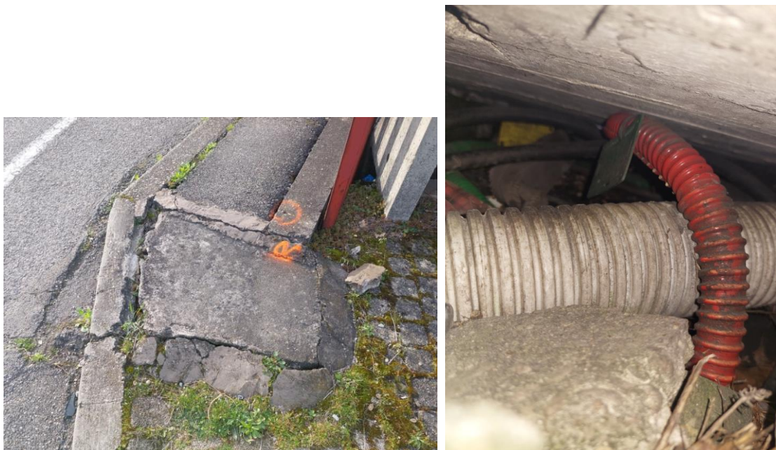
Figure 18 : fourreaux et regards existants
